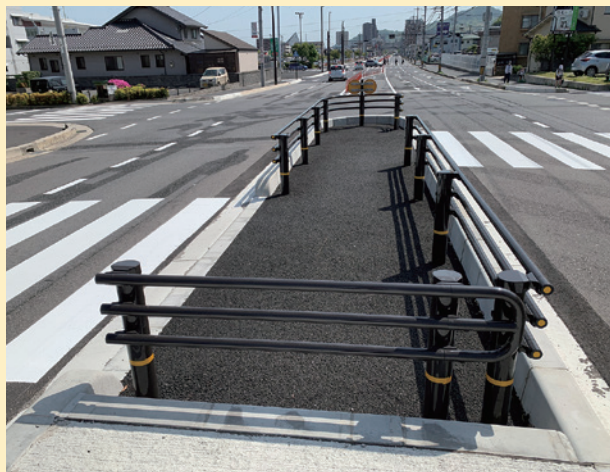
無信号2段階式横断歩道 (広島経済大学フットボールパーク付近)
